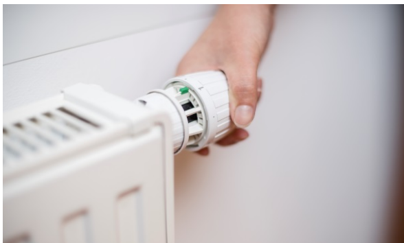
Abbildung 3: Thermostatventil am Heizkörper © Robert Herbst www.pov.at
